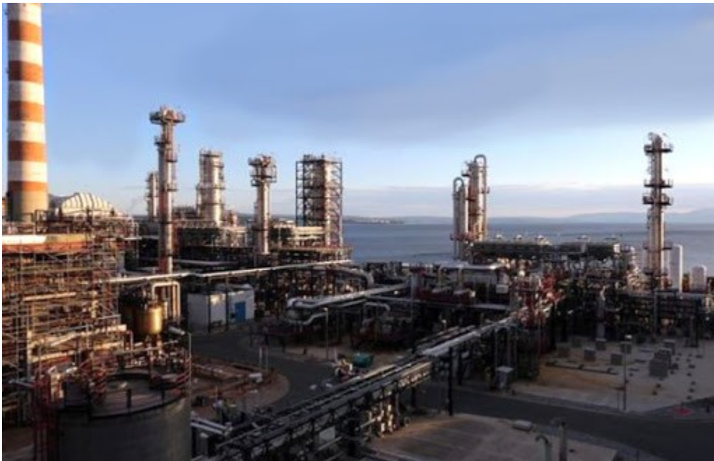
Slika broj 1: Kotlovi i kotlovska postrojenja
